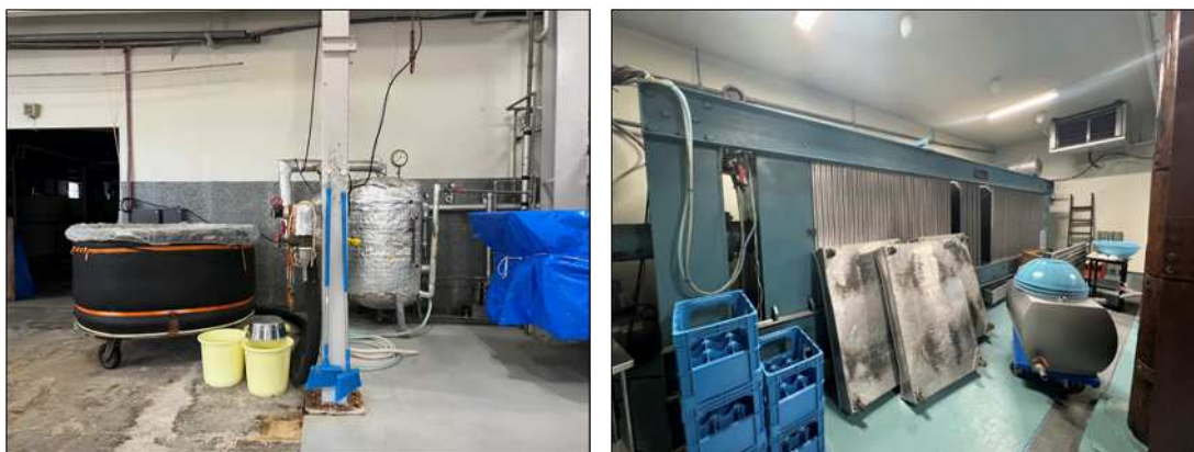
図表 1-12 復水が捨てられている蒸米機(左)と部屋全体を冷房している上槽室(右)
