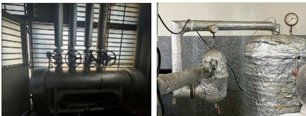
図表 1-11 保温対策をしていないボイラーのヘッド(左)と保温対策を施した配管(右)
