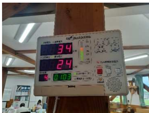
図表 1-7 社屋に設置されているデマンド監視装置
