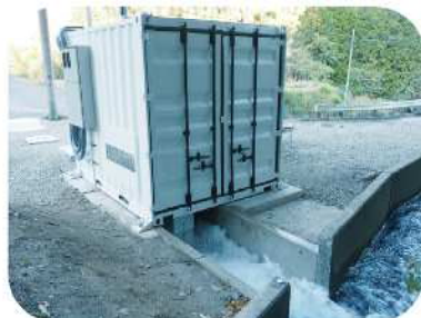
吉野ヶ里町松隈地区の小水力発電システム
